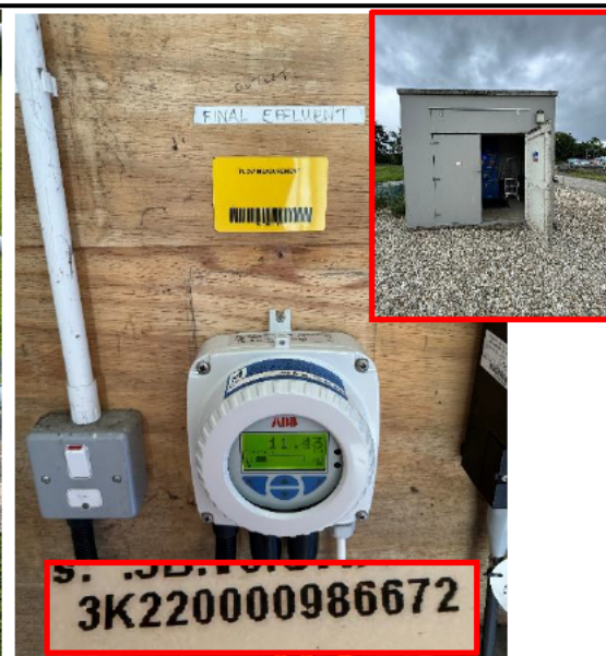
Site Flow Meter Display
